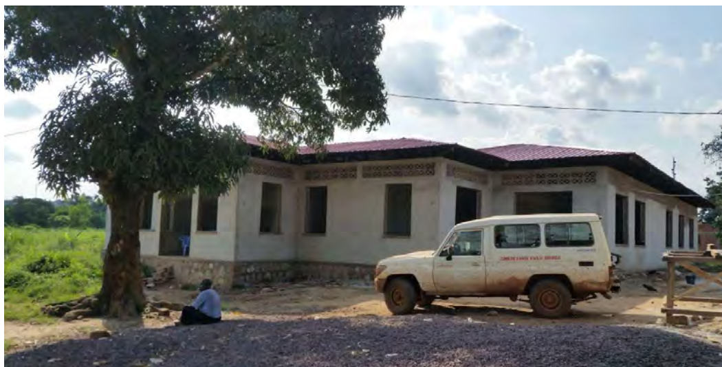
Der Bau des Gesundheitszentrums in Kwilu Ngongo ist fast fertig – dann wird eingerichtet © Viktor Böhm
